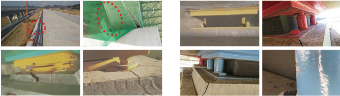
교량 상부구조 변위발생 및 균열, 받침 파손
