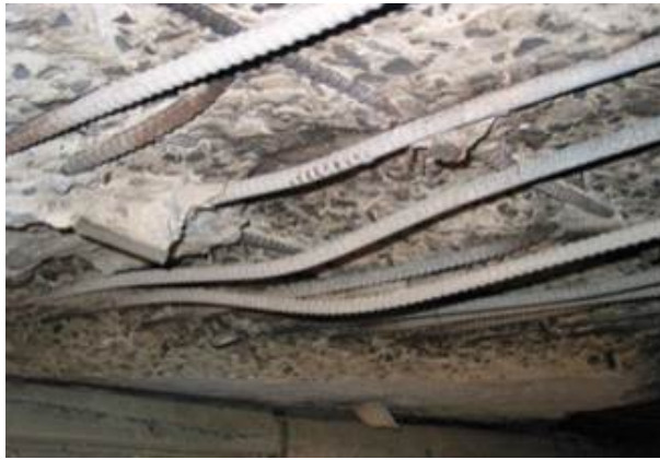
그림 2.5 고온노출로 인한 콘크리트 구조물의 표면 스폐링 피해 사례
