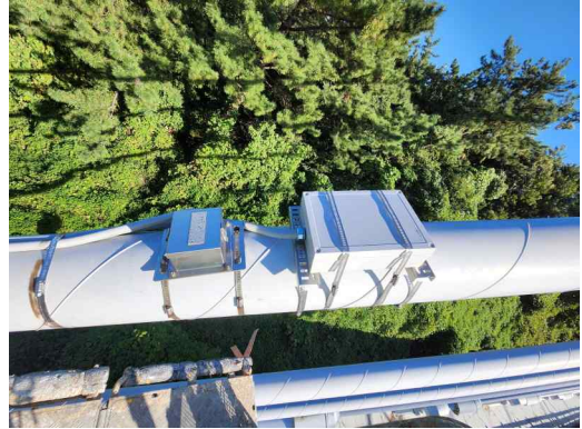
센서 및 보호관 설치 완료(CAC08)
