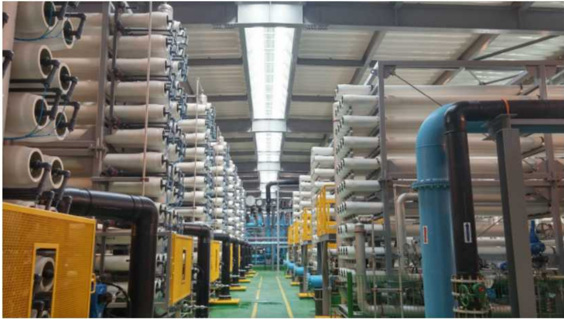
광양제철소 해수담수화 시설. 포스코 광양제철소는 국내 최초로 상용화 해수담수화시설을 활용해 1일 산업용수 소모량인 26만 톤의 12%에 해당하는 용수를 제공받는다. /제공=포스코 광양제철소
